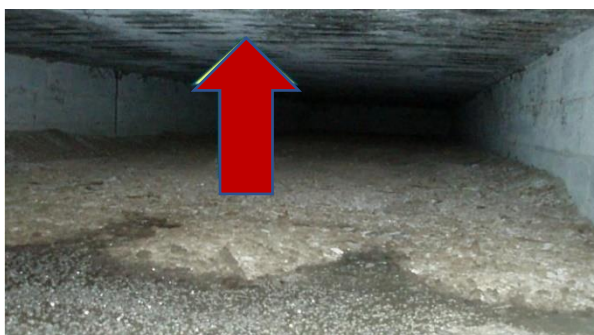
Figure 3 – Gaine enterrée et caillebotis avec dépôts de terre et CIPC
